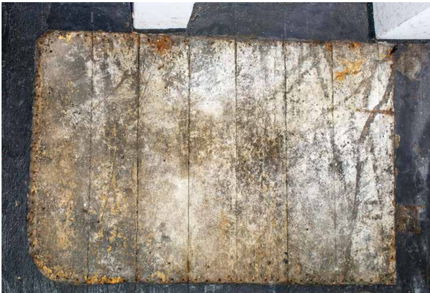
Spor i gulvet etter metallplate.
